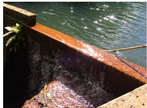
Figura 3 – Barramento COPASA Córrego Limoeiro
