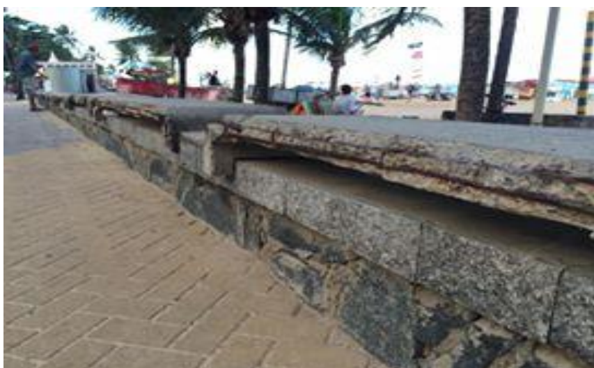
Figura 2 – Corrosão de armaduras nos bancos de concreto na Orla de Boa Viagem
